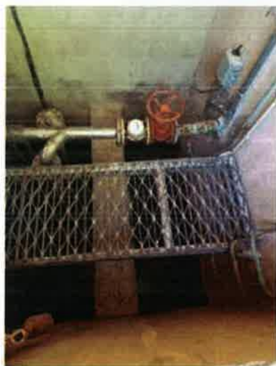
Photographie intérieure de la bêche de réunion de 6 m 3
